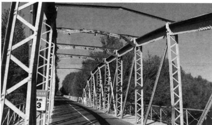
El mal estado de los elementos metálicos es visible a primera vista. RAQUEL MELÉNDEZ
